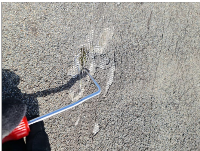
Рис. Повреждение кровли (фото автора)
